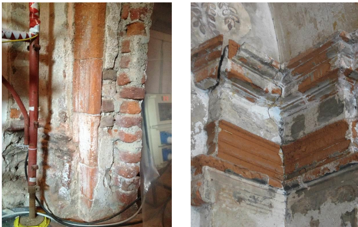
Figure 3 e 4. A sinistra. Efflorescenze bianche sugli elementi in terracotta che costituiscono lo stipite della porta. A destra. Lacune nello strato di finitura bianco presente sulle cornici in terracotta. Esfoliazioni diffuse sono presenti sul corpo ceramico.
