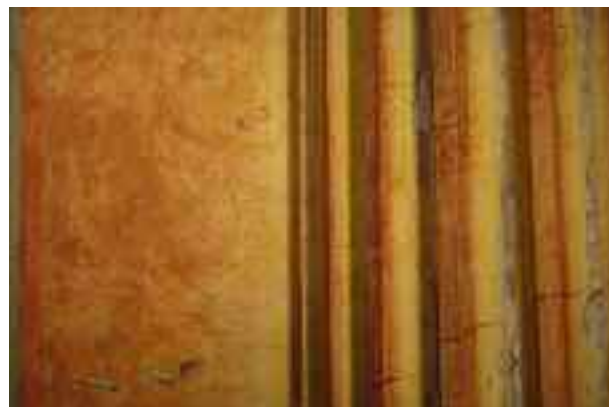
Fig. 2. Particolare di una delle colonne d'angolo della parete Nord. L'alterazione in rosso corrisponde alle zone lambite dalle fiamme e calcinate dal calore.
