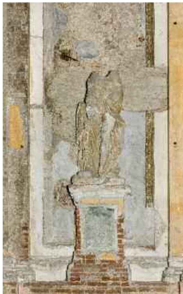
Fig. 40. Vasta lacuna della struttura muraria risarcita con cemento. Ancora ben visibili i segni della cassaforma di contenimento.
