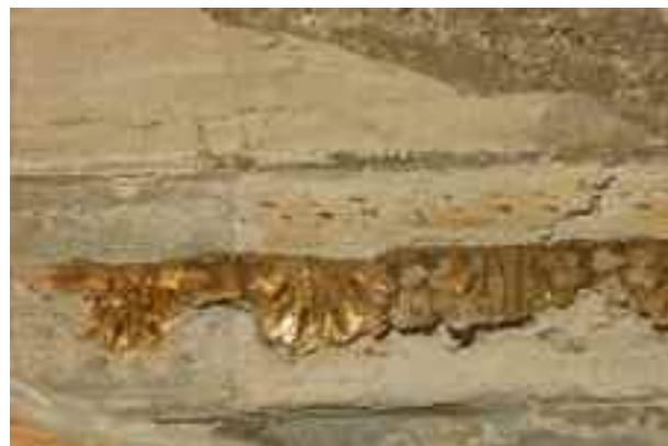
Fig. 17. Particolare di una delle cornici dorate, che poggia su uno stucco completamente disgregato.
