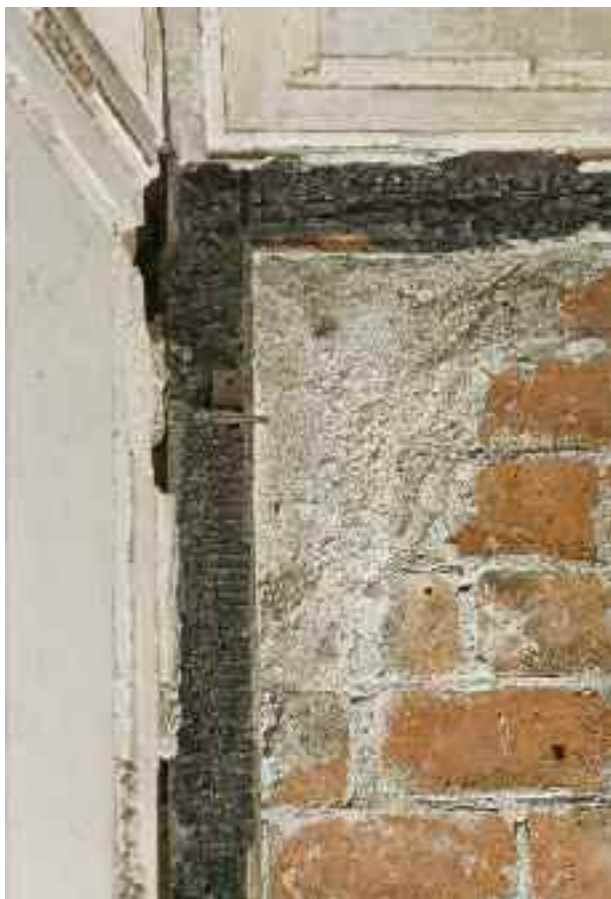
Fig. 7. Finestra all'angolo tra parete Est e Nord. La tamponatura di mattoni ha risparmiato il telaio bruciato della finestra originale; nella parte alta sono rimasti anche i cardini delle ante vetrate (foto di M. Ranzani).
