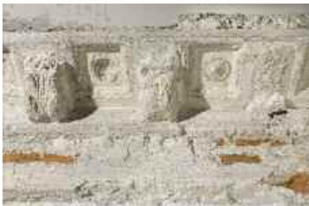
Fig. 16. Particolare dei fenomeni di polverizzazione sul cornicione sommitale (foto di M. Ranzani).
