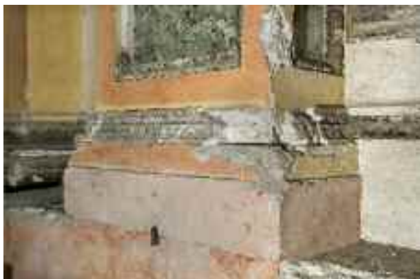
Fig. 1. Basamento di una delle statue tra parete Est e Nord. Il marmorino giallo è rimasto intatto sul lato, evidentemente poco esposto al fuoco, mentre è virato in rosso sul fronte (foto di M. Ranzani).
