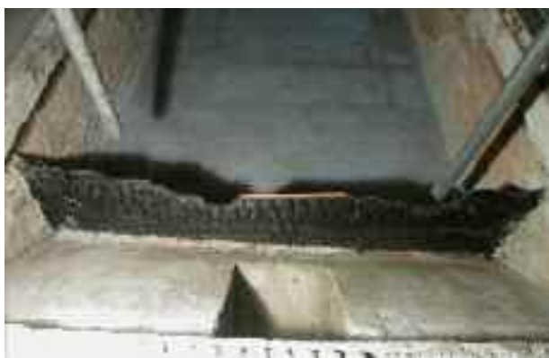
Fig. 8. Impiantito sporgente dall'apertura di sinistra della parete Nord, nell'ordine superiore. La spessa trave in legno che reggeva la pavimentazione in medoni è stata gravemente lesionata dall'incendio.
