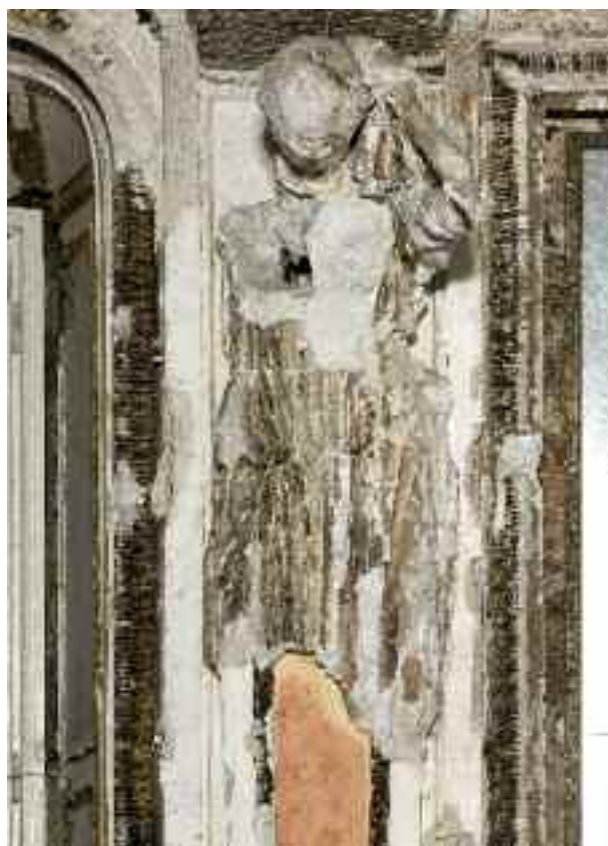
Fig. 6. Cariatide sulla parete Est, prima del restauro. Molto evidenti le alterazioni degli strati di patinatura nelle zone intatte della veste, e nelle dorature delle cornici ai lati (foto di M. Ranzani).
