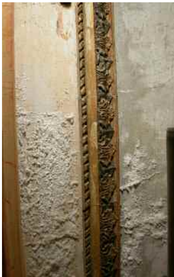
Fig. 21. Efflorescenze saline nella partitura architettonica all'angolo tra parete Nord e Ovest.
