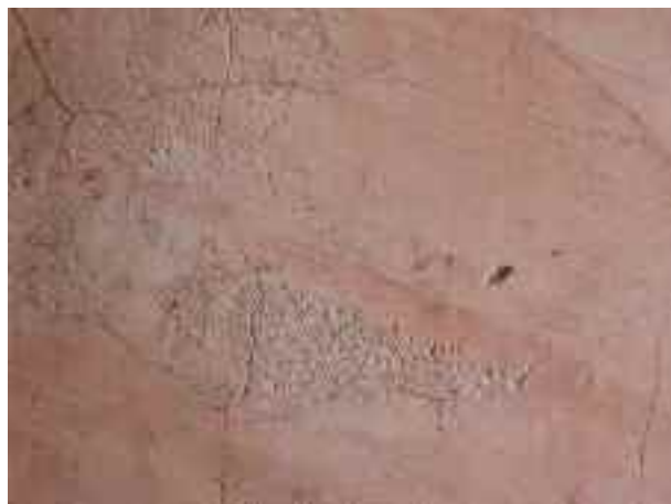
Fig. 15. Microcrateri provocati dalla fuoruscita di sali solubili intaccano tutte le finiture del partito architettonico (foto di M. Ranzani).
