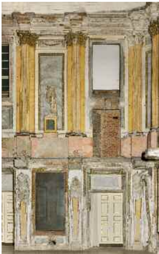
Fig. 39. Zona della parete Est confinante con la Sala delle Udienze. Oltre al sopraporta edificato nel 1838, sono individuabili tamponature diverse eseguite in momenti diversi della vita della Sala (foto di M. Ranzani).
