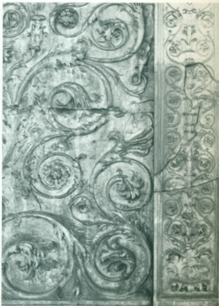
32 - Descrizione dello stato di conservazione. Strati sovrapposti. Depositi superficiali di particellato (part. dal riquadro decorativo sottostante la Roma).
