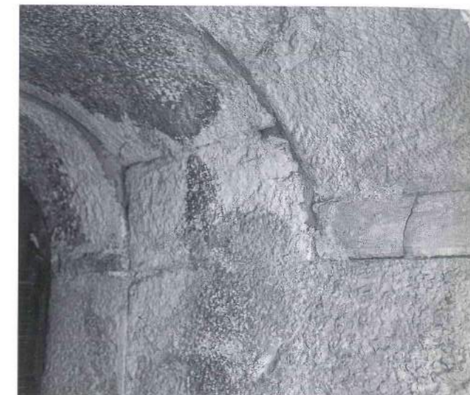
2°Ordine, volta dello strombo della finestra, dopo la rimozione delle stuccature di restauro risultano evidenti le diversità di curvatura dei vari blocchi e la mancanza di lavorazioni di raccordo e correzione.
